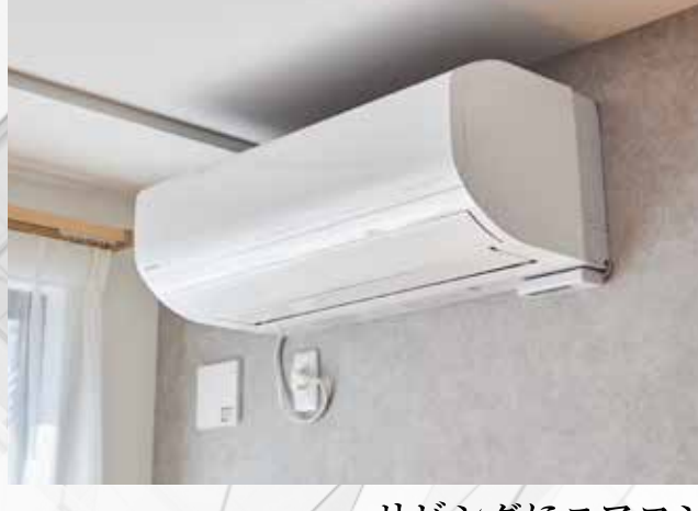
リビングにエアコン
